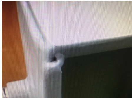
Slika 4.4 Nepretaljeni završetak zavora, potencijalno mjesto nakupljanja nečistoće, hrđanja
