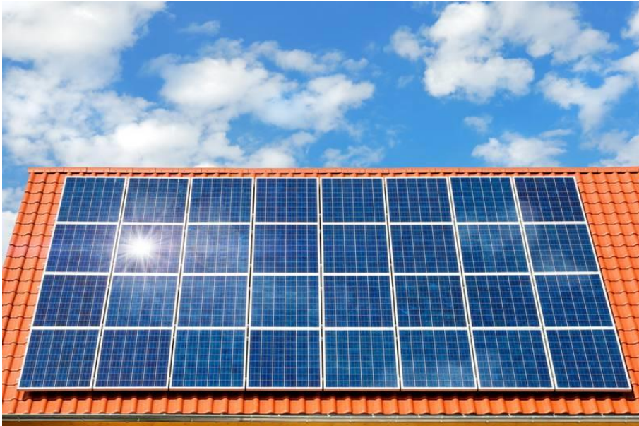
Slika 12. Solarni fotonaponski paneli na krovu
