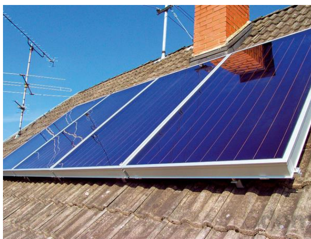
Slika 3.1.5. Solarni kolektori na krovu
