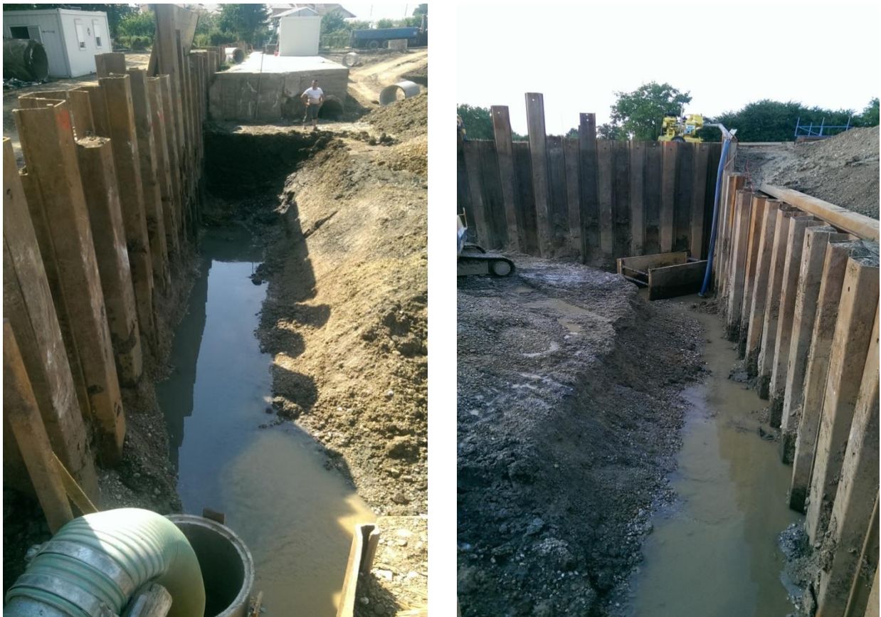
Slika 49. Voda u građevinskoj jami KP-II
