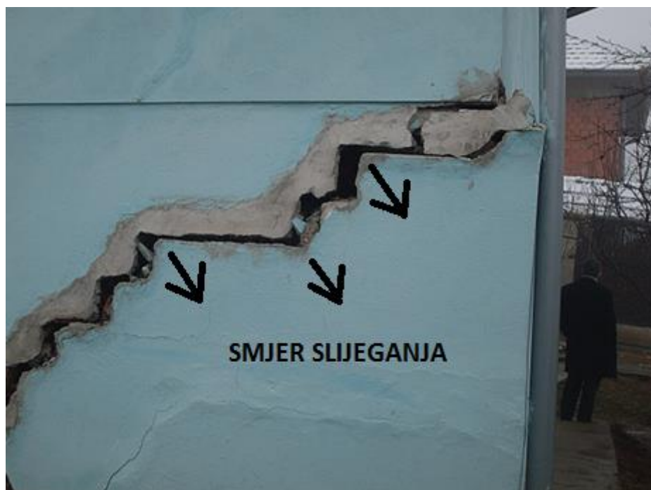
Slika 3.5. Pojava pukotine uslijed slijeganja tla
