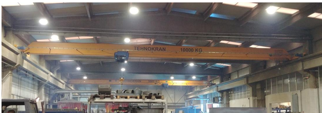
Slika 4. Kranovi u zavarivačkoj radionici
