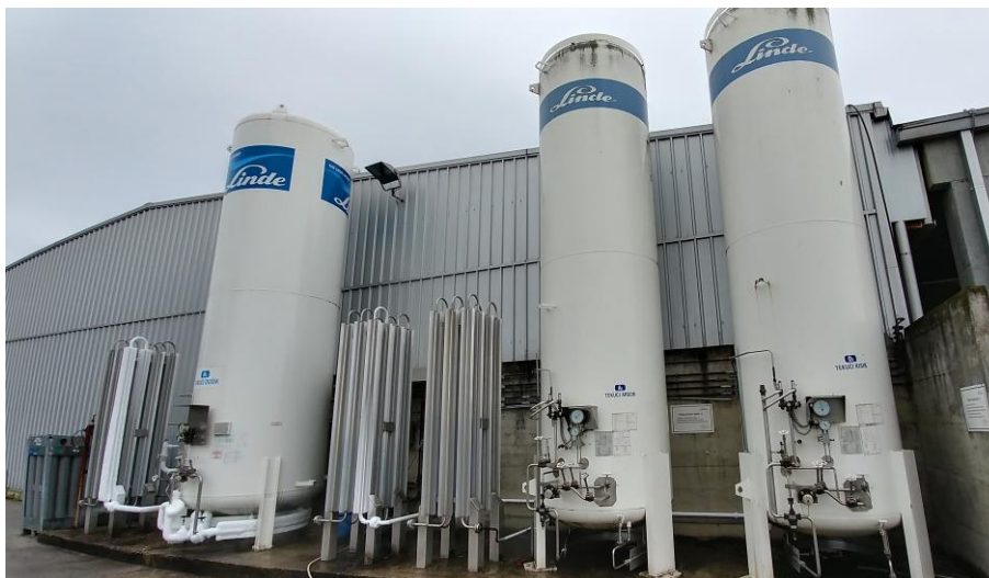
Slika 25. Vanjski spremnici tehničkih plinova
