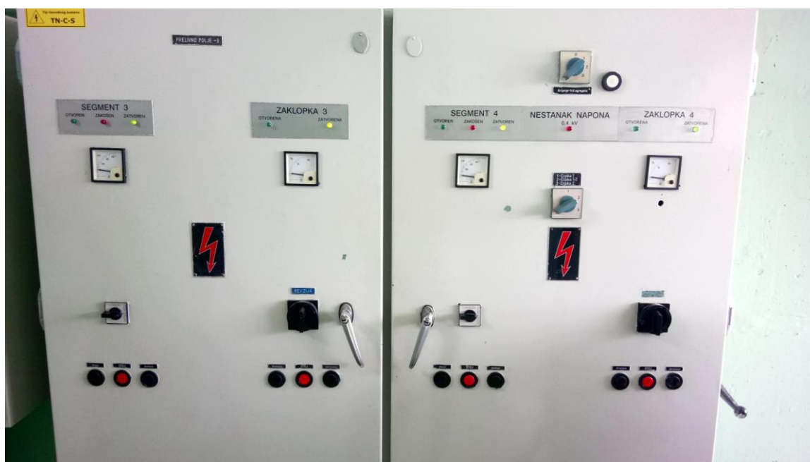
Slika 2.14. Upravljački ormari preljevnih polja
