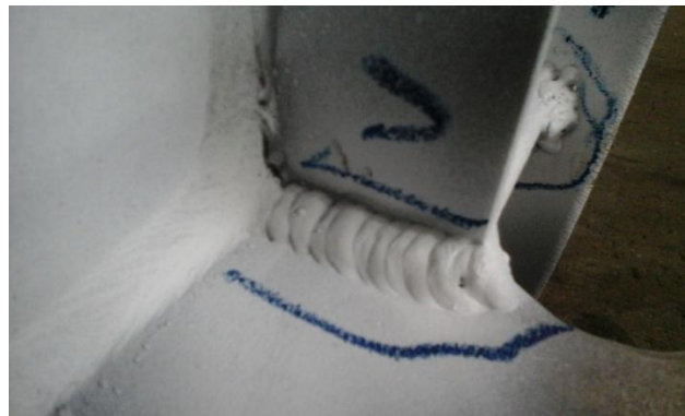
Slika 4.2.8 Primjer neprihvatljivog zavara
