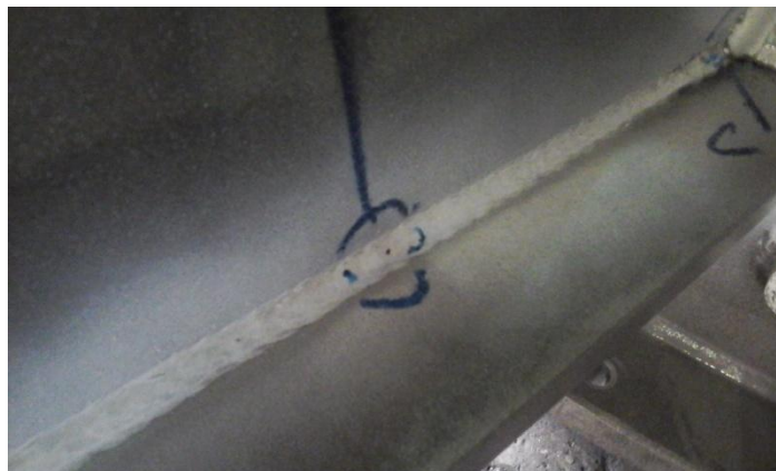
Slika 4.2.4 Poroznost završetka zavara
