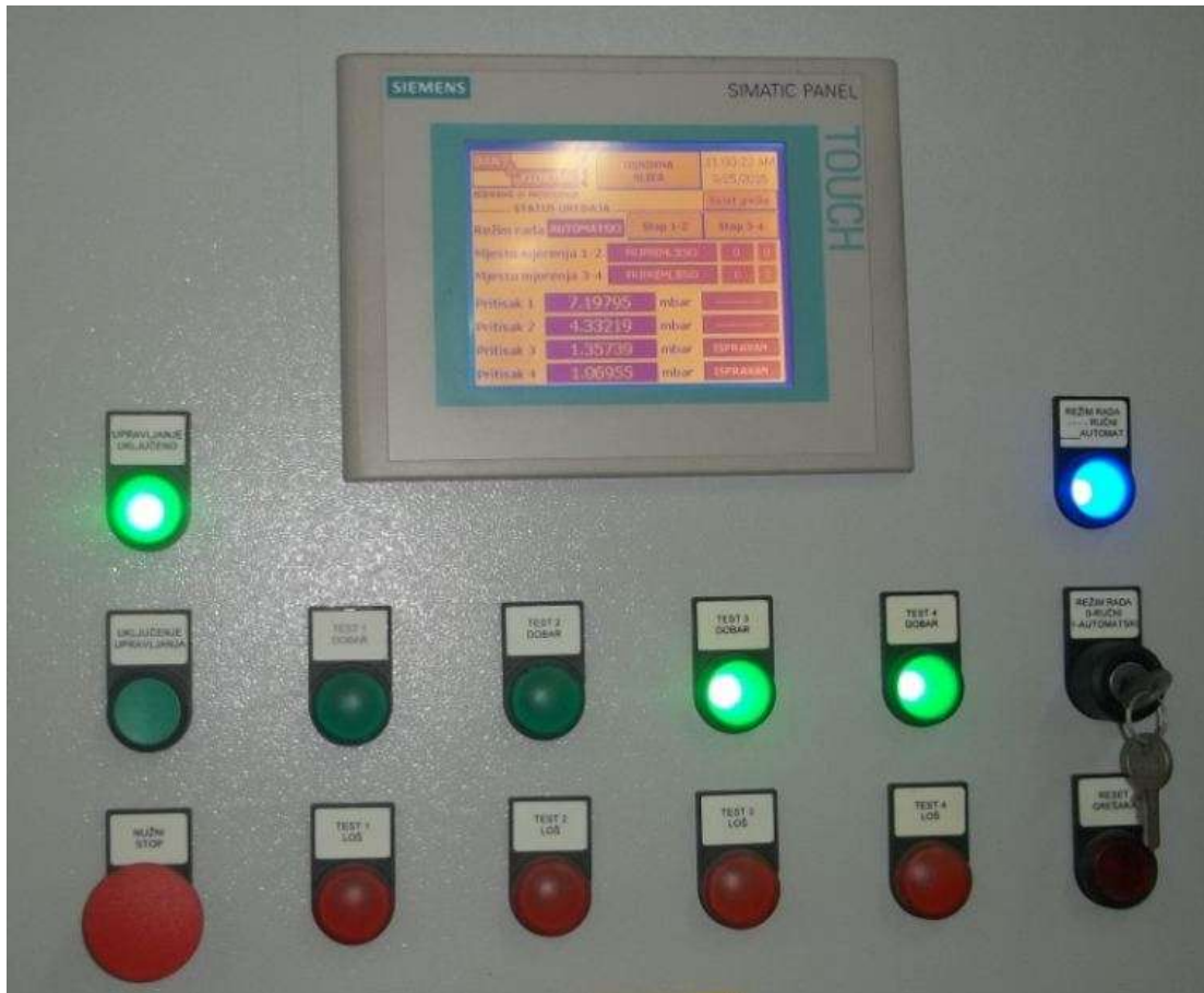
Slika 3.2.1. Kontrolna ploča kontrole vakumiranja
