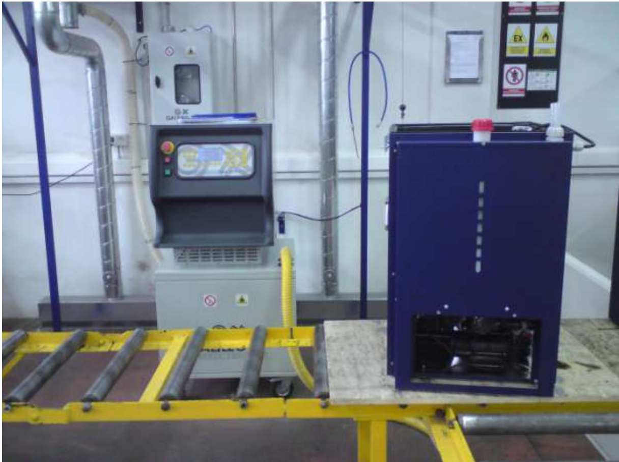
Slika 3.3.1. Kontrolna stanica za punjenje
