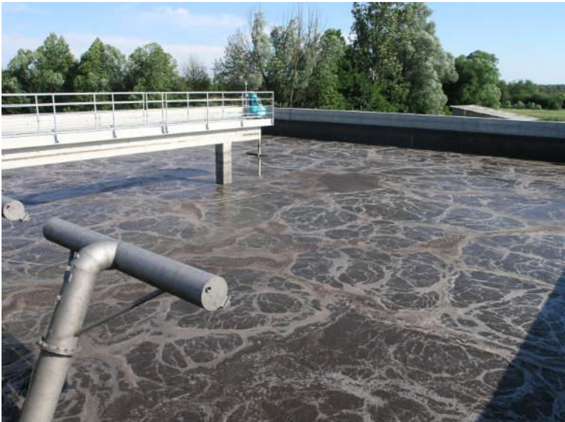
Slika 3.3.1.: Uređaj za pročišćavanje voda
