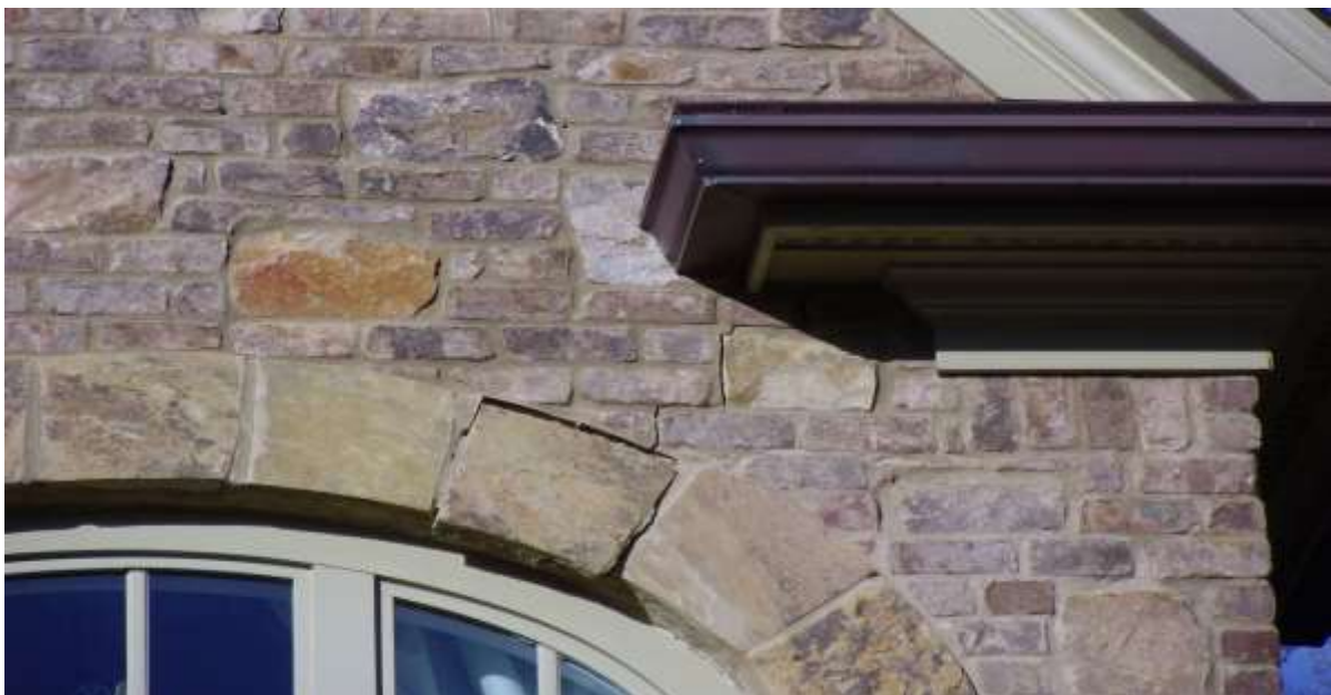
Slika 14. Pojava pukotina na kamenoj fasadi
