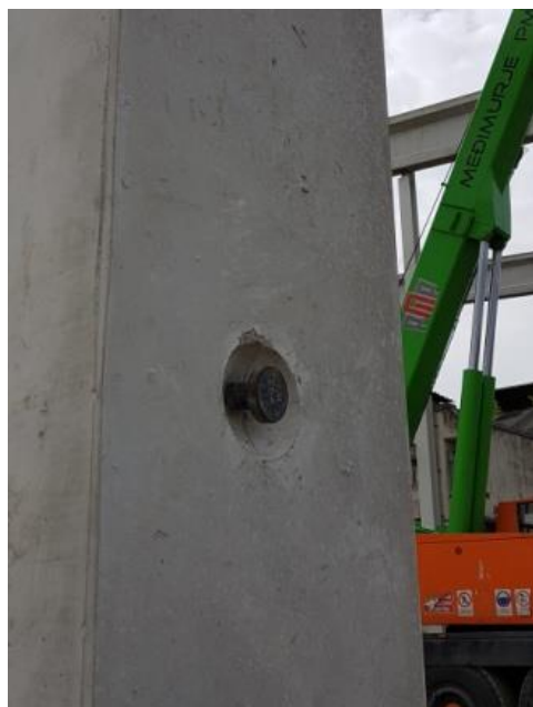
Slika 73. Prihvatnik na AB stupu koji se koristio kod utovara i istovara AB elemenata pomoću autodizalice
