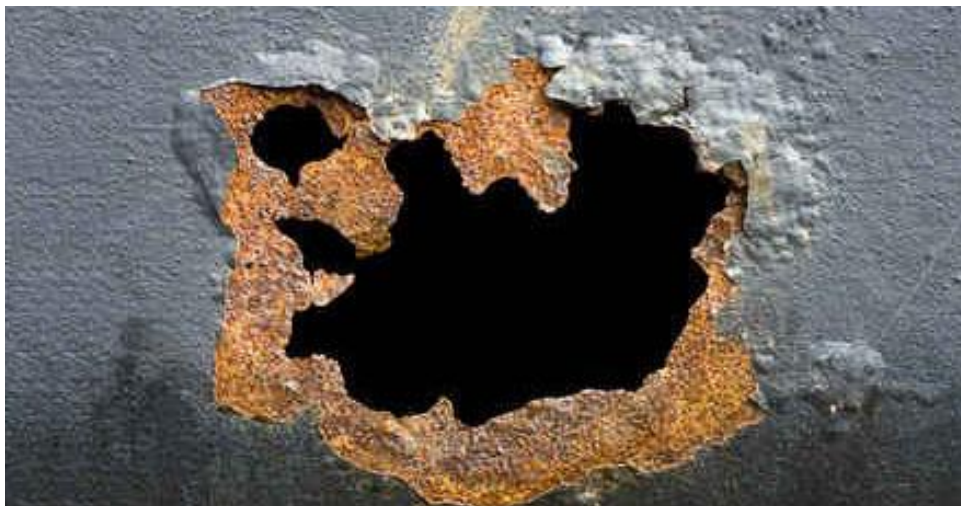
Slika 1. Pukotina nastala djelovanjem korozije na ugljičnom čeliku [13]
