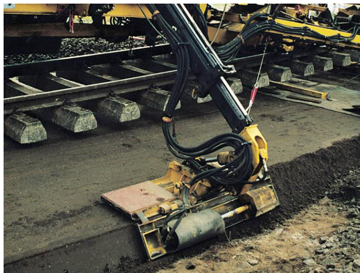
Slika 12. Završna faza uređenja novog konsolidiranog tamponskog sloja [9]
