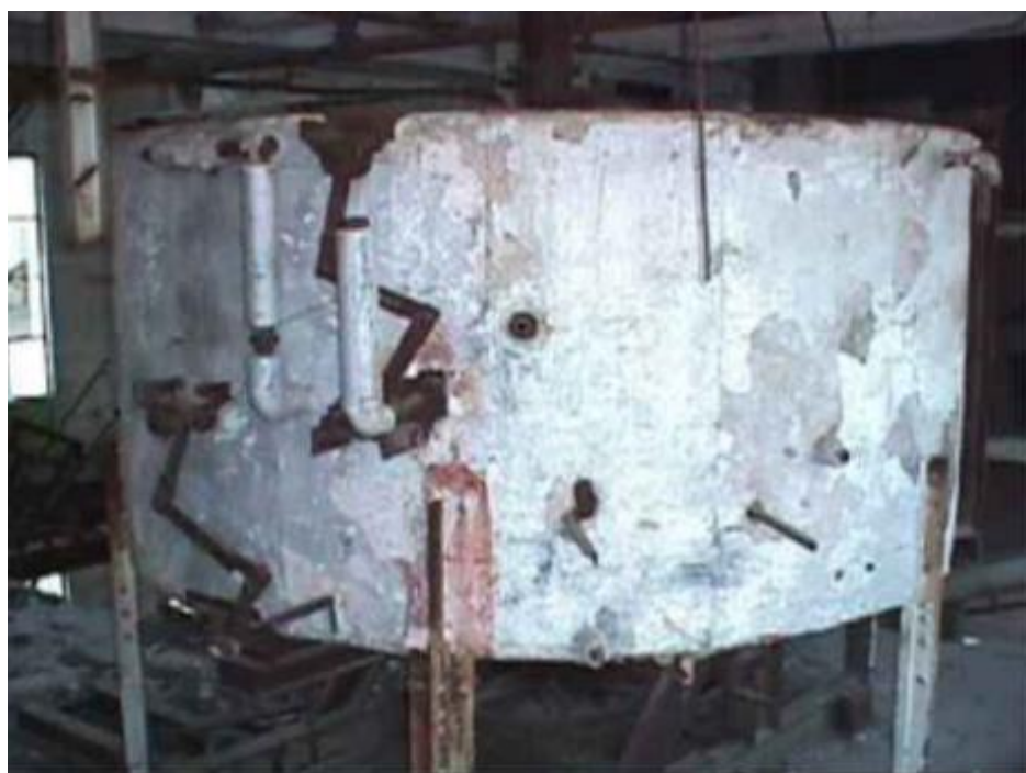
Slika 3.7. Prikaz kotla centralnog grijanja obloženog azbestom
