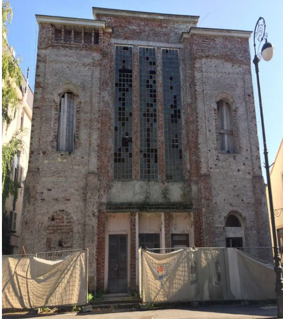
Slika 3.5. Fotografija devastiranog pročelja varaždinske sinagoge u ulici Augusta Cesarca 16a. Fotografirala: Ana Bašić
