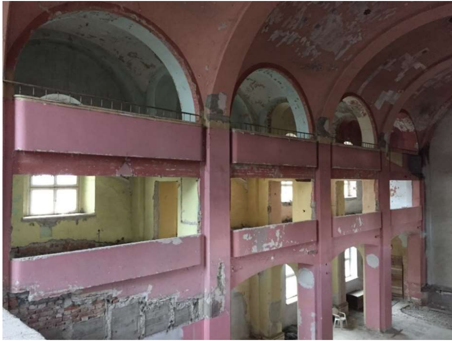
Slika 3.13. Pogled na I. i II. kat galerije te prikaz oštećenja i zapuštenosti zidanih elemenata. Fotografirala: Ana Bašić
