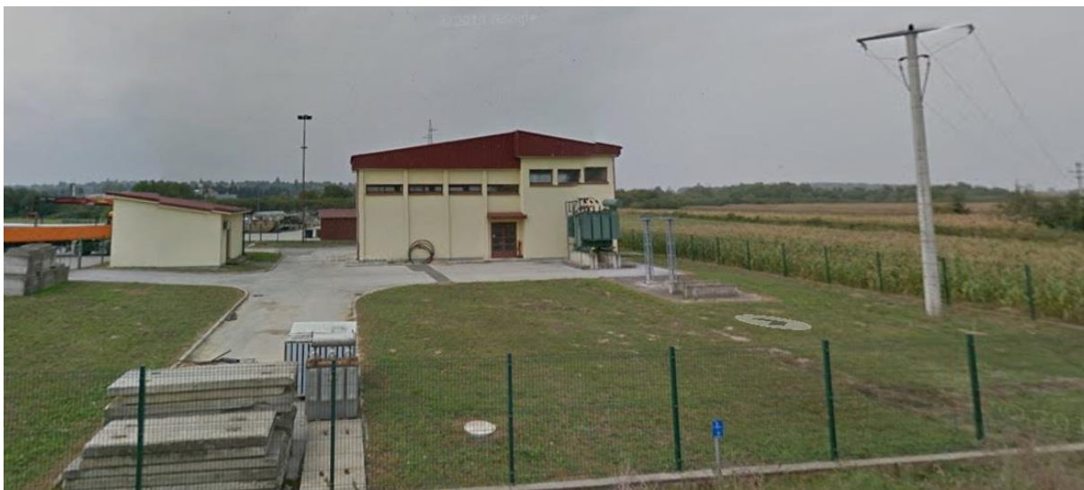
Slika 7 Trafostanica 35/10 kV u građevinskom obliku, Koprivnica
