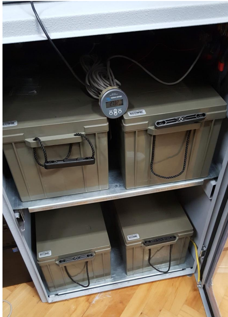
Slika 3.4 Baterijski sustav, Baterije Victron Energy AGM 12 VDC/220Ah
