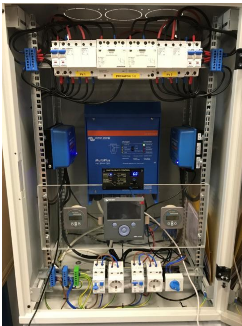
Slika 5.3: Ormar sa uređajima fotonaponskog sustava
