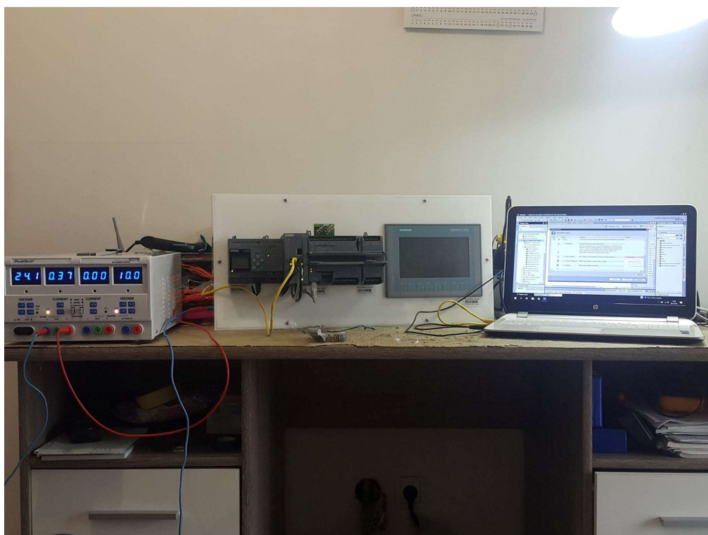
Slika 4.3. Prikaz PLC-a i HMI uređaja koji su spojeni na napajanje i računalo
