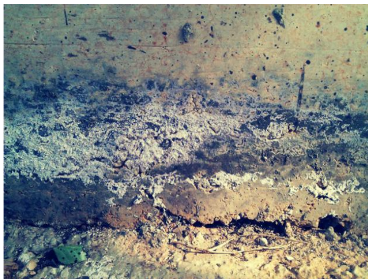
Slika 4. Kristalizacija soli na betonskom zidu
