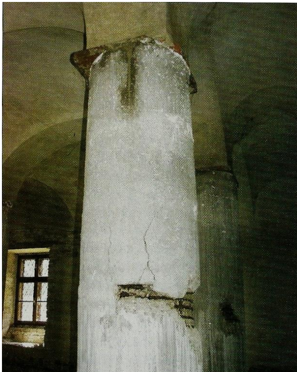
Slika 26. Vlagom i solima nagrižen stup i zahrđana željezna armatura
