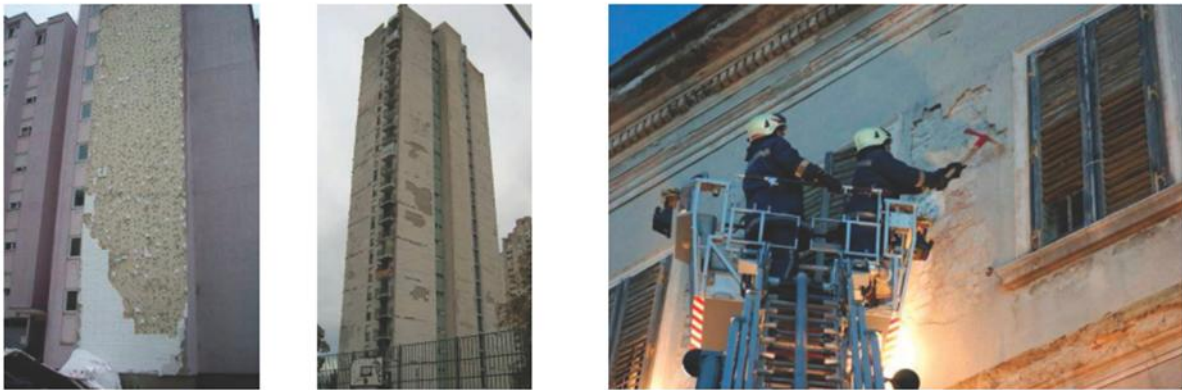
Slika 5., 6., 7. Propadanje vanjske ovojnice zgrade
