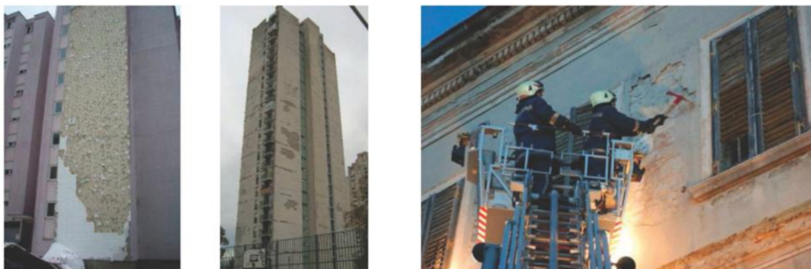
Slika 5., 6., 7. Propadanje vanjske ovojnice zgrade
