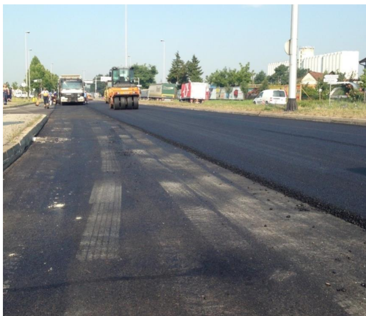
Slika 7. Ugradnja veznog sloja asfalta VS 22 – Zagreb Žitnjak (izvor: baza podataka Zagrebačke ceste)
