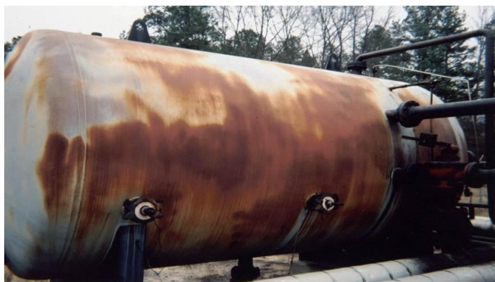
Slika 4. Primjer opće korozije na spremniku[24]
