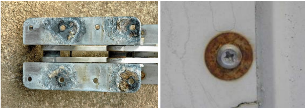
Slika 7. Galvanska korozija okovnja, korozija ploške u spremniku [4, 27]
