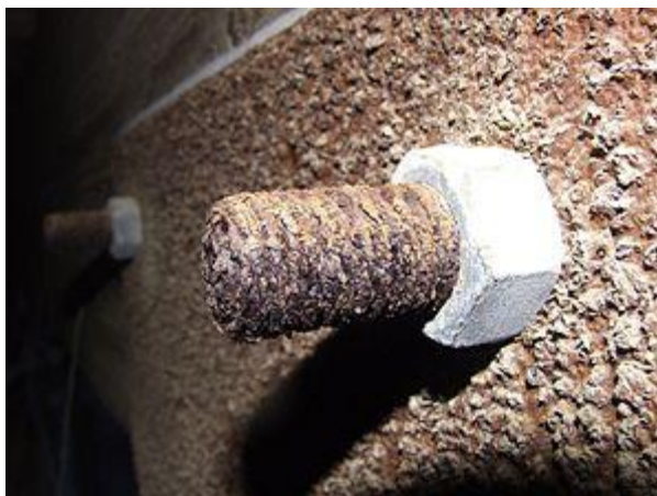
Slika 3. Elektrokemijska korozija u spremniku s vodom [45]
