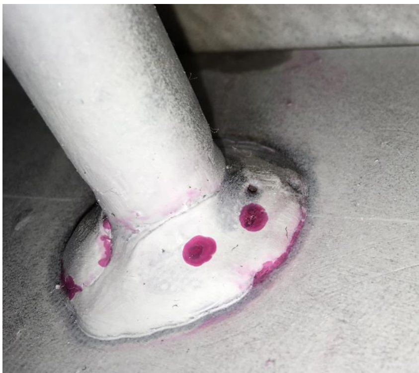
Slika 9: Šupljine u zavarenom spoju, dio indiciran penetrantskom metodom
