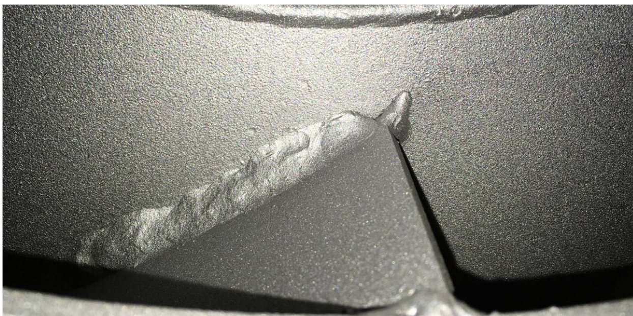
Slika 14: Pogreška oblika zavara zbog loše tehnike zavarivanja
