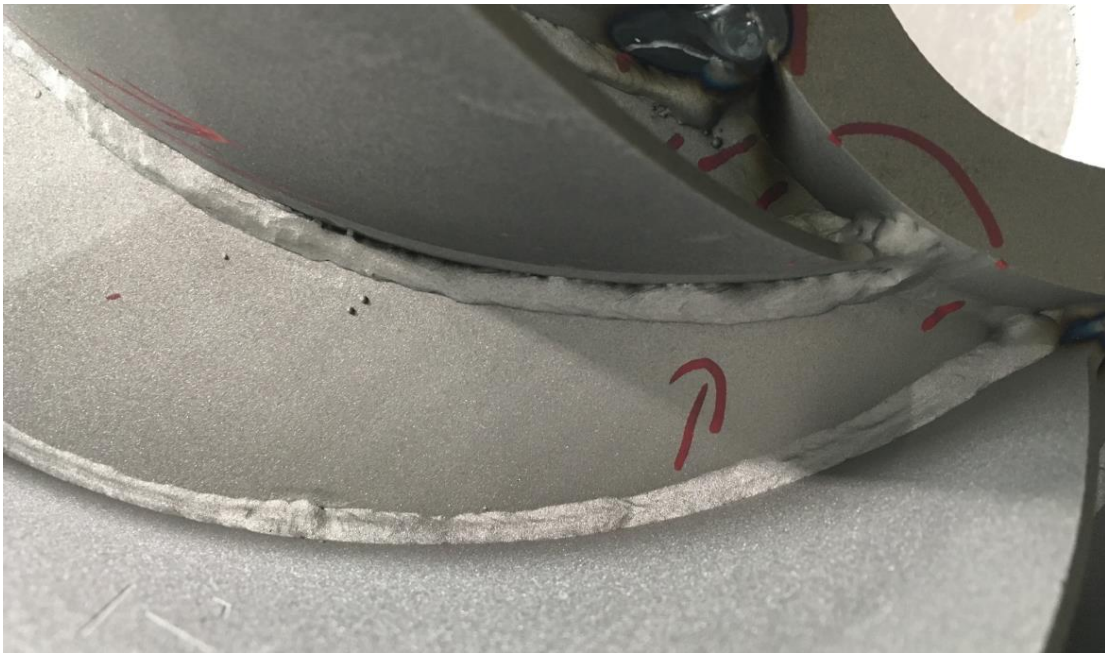
Slika 12: Naljepljivanje utvrđeno vizualnom kontrolom
