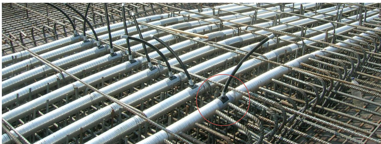
Slika 2.6 Kontrolne cijevi za odzračivanje
