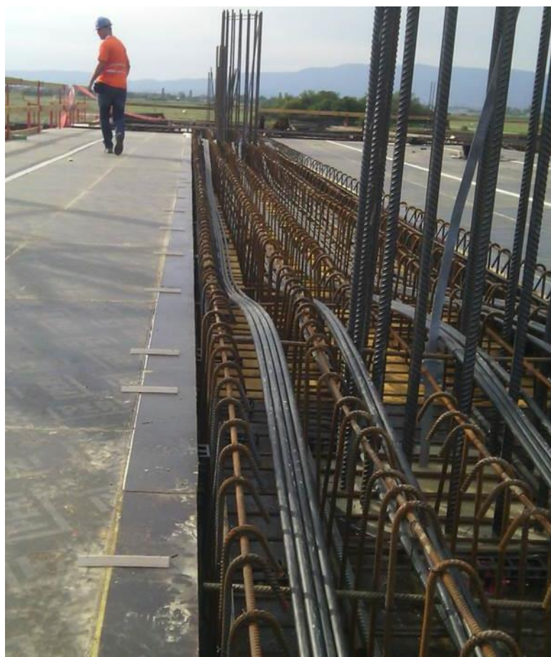
Slika 5.2 Zračna luka u Zagrebu – položaj kabela u zoni stupova
