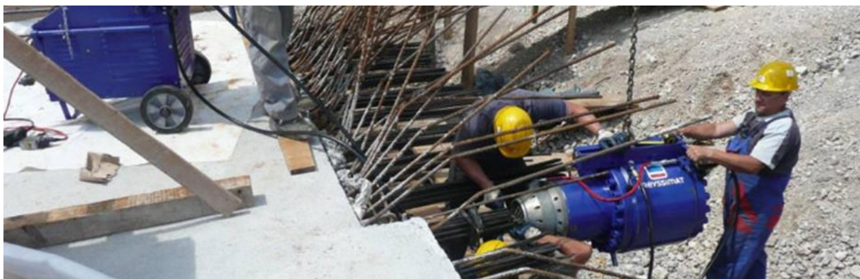
Slika 3.2 Preša za naprezanje kabela
