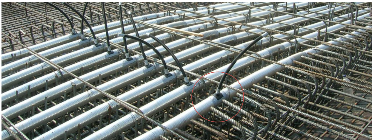
Slika 2.6 Kontrolne cijevi za odzračivanje
