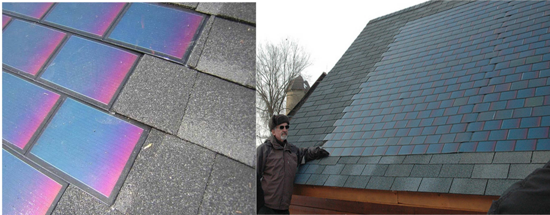
Slika 3.7. Primjeri solarne šindre ugrađene u kombinaciji s klasičnom šindrom
