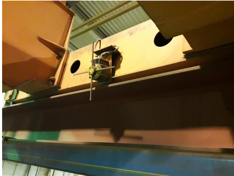
Slika 4.6: Krajnji isključivač instaliran na konstrukciju dizalice [20]
