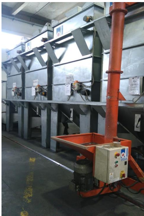
Slika 5. pužni transporter i silosi
