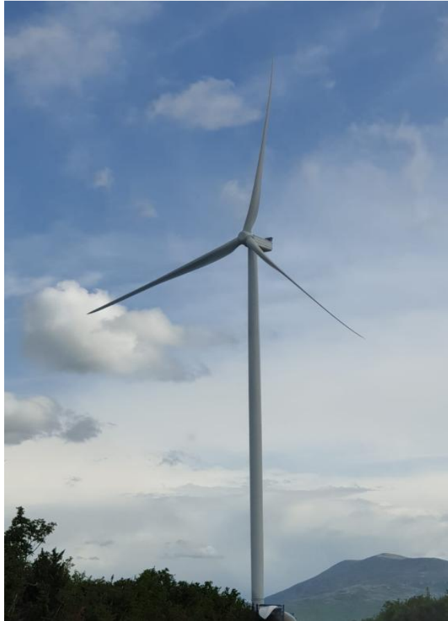
Slika 11: Vjetroelektrana u vjetroparku "Krš Pađene"
