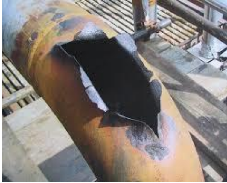
Slika 1.11 Erozijsko korozijsko oštećenje cjevovoda za transport nafte [13]
