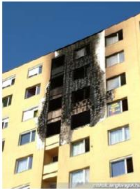
Slika 7.1 Posljedice požara na pročelju stambene zgrade u Mađarskoj
