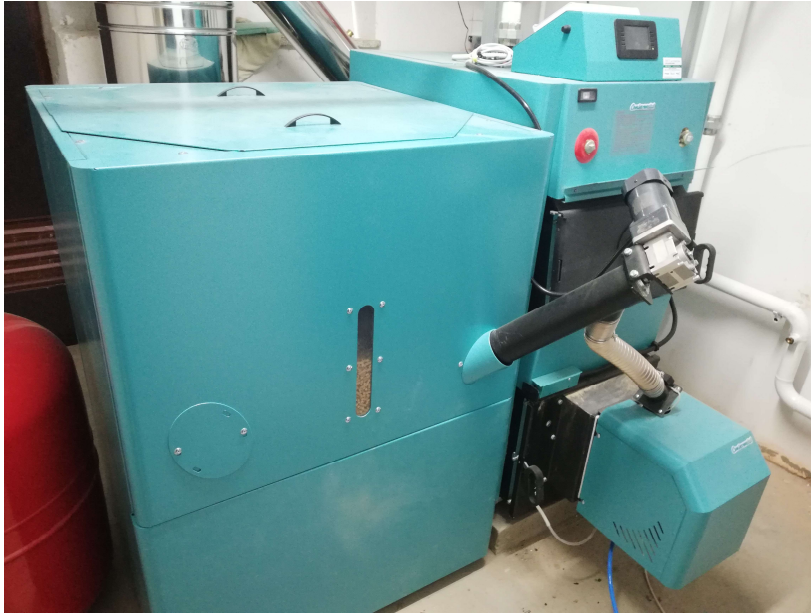
Slika 3.4.1 Postojeći kotao na pelete
