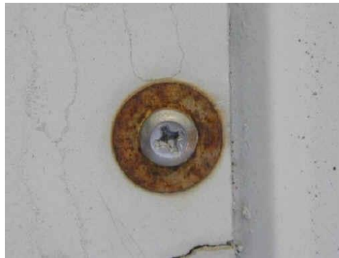
Slika 9.: Primjer kontaktne korozije [8]
