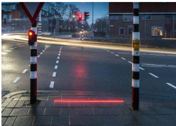
Slika 9. Prometno svjetlo ugrađeno u pločnik
