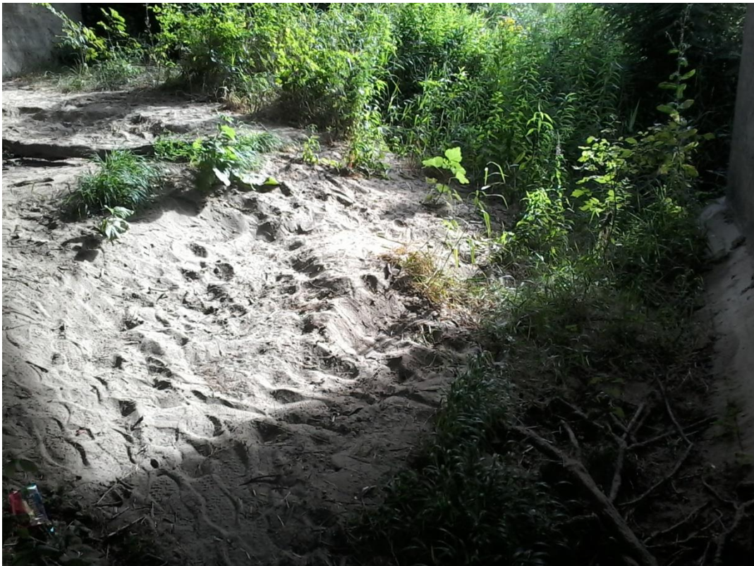
Slika 3.12. Nanos ispod mosta koji je rijeka nanjela uslijed visokih voda[8]
