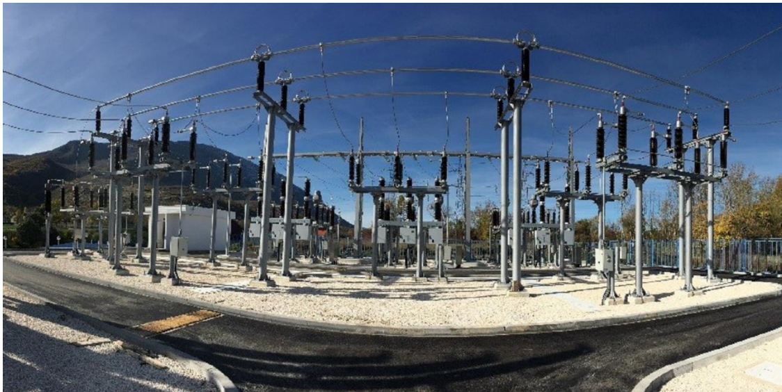
Slika 2.4 Rasklopno postrojenje od 110 kV [7]
