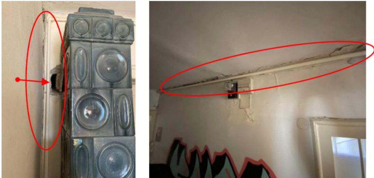
Slika 5.19. - Vertikalna pukotina uz dimnjak (lijevo) te horizontalna pukotina uz strop (desno)
