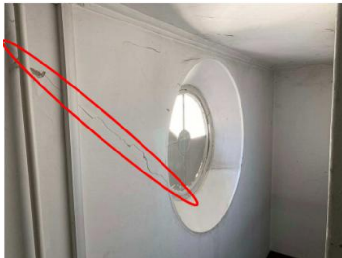
Slika 5.51. - Pukotine po vanjskim zidovima stubišta
