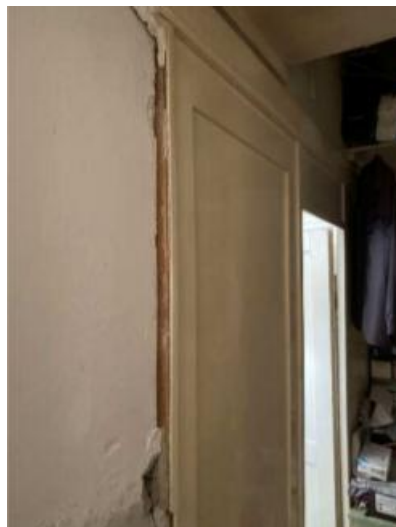
Slika 5.28. - Odvajanje okvira vrata zbog potresnog udara
