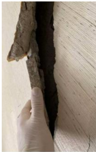
Slika 5.25. - Potpuno raspucavanje i odvajanje žbuke sa pregradnih zidova etaže
