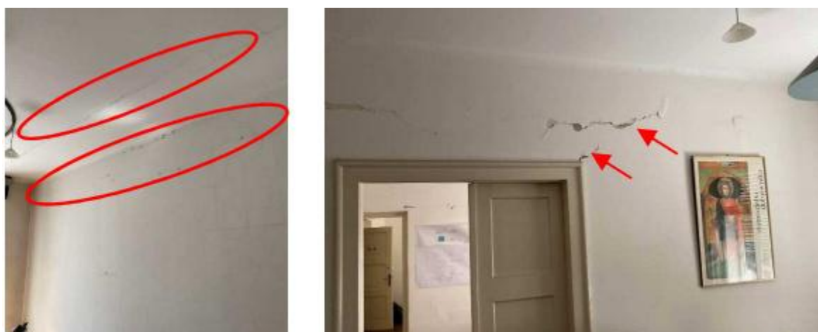
Slika 5.39. - Pukotinski sustav na pregradnom zidu smjera sjever-jug
