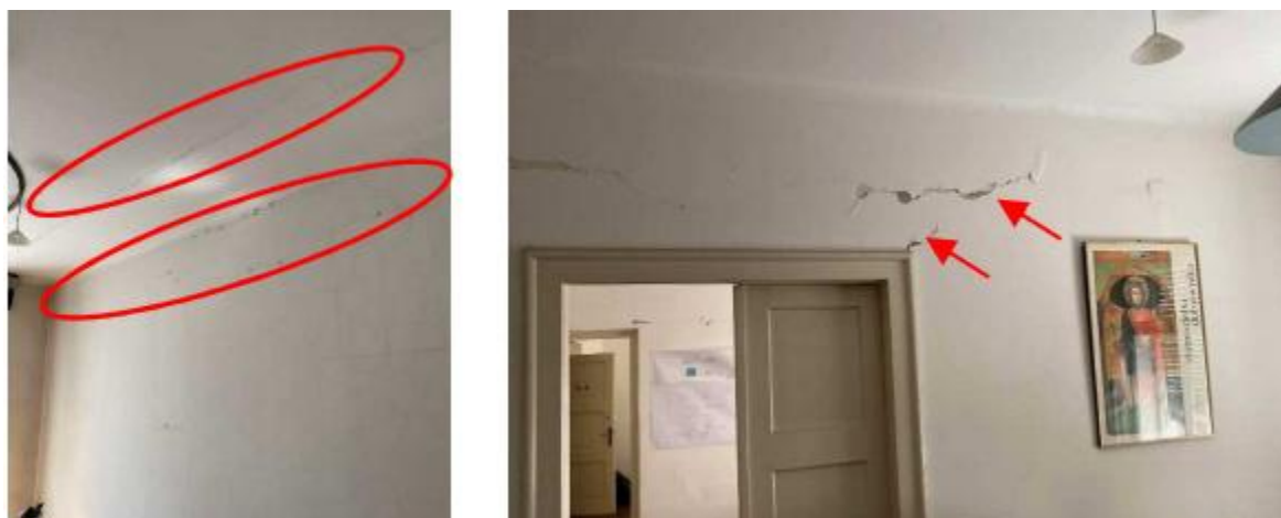
Slika 5.39. - Pukotinski sustav na pregradnom zidu smjera sjever-jug
