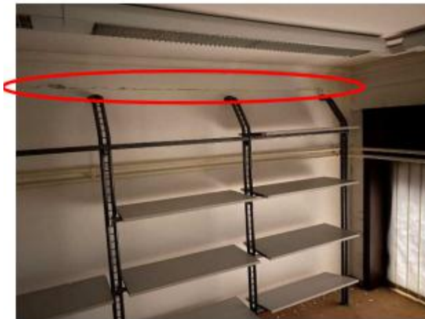
Slika 5.42. - Horizontalna pukotina na krajnjem istočnom zidu
