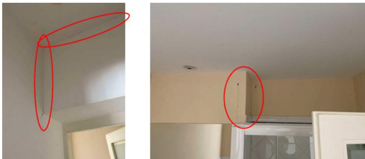
Slika 5.7. - Vertikalne i horizontalne površinske pukotine
