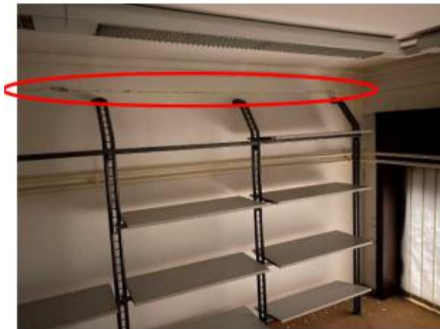
Slika 5.42. - Horizontalna pukotina na krajnjem istočnom zidu
