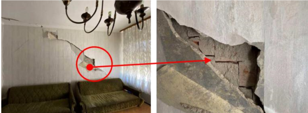
Slika 5.26. - Dijagonalna pukotina na pregradnom zidu
