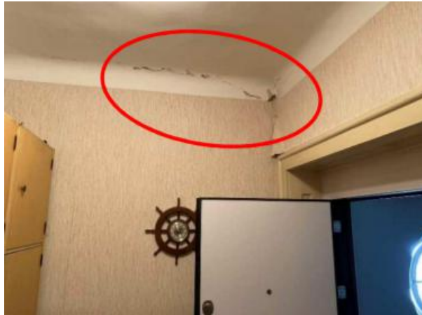
Slika 5.27. - Horizontalne pukotine uzduž stubišnog zida
