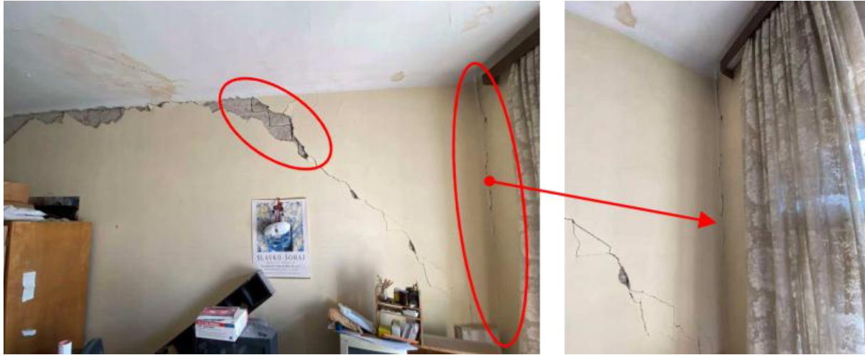
Slika 5.31. - Dijagonalna pukotina te njezino propagiranje do vertikalne pukotine na vanjskom nosivom zidu
