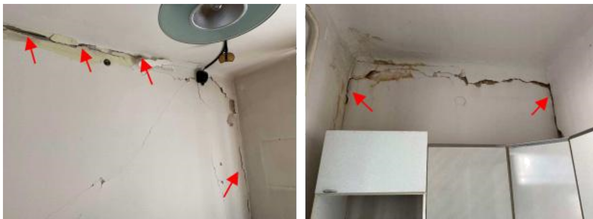
Slika 5.40. - Potpuna odvajanja zidova i stropova
