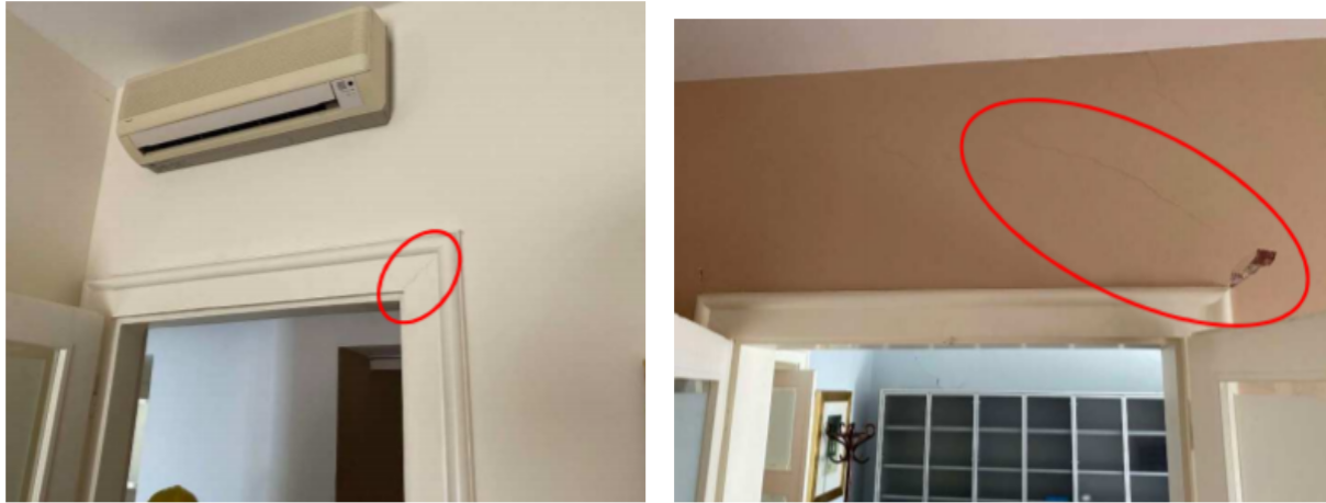
Slika 5.8. - Dijagonalne pukotine na unutarnjim otvorima zidova
