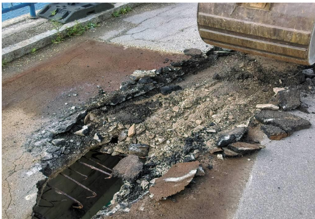
Slika 9. Oštećenje kolničke ploče mosta Klanac kod Gospića
