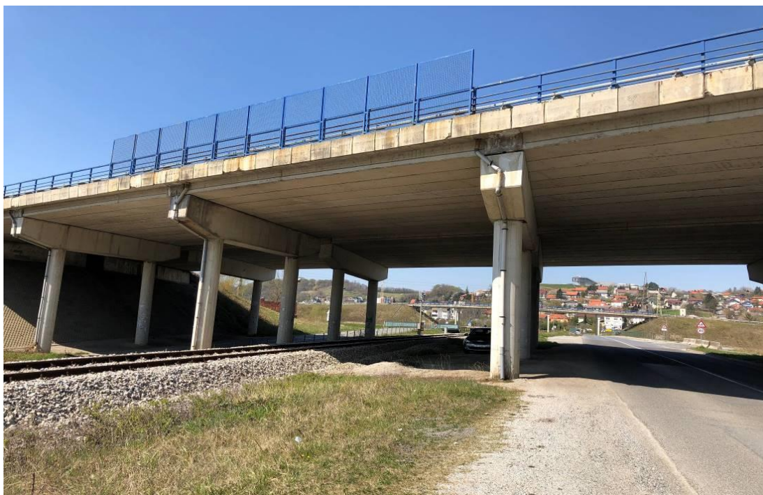
Slika 70. Zatečeno stanje nadvožnjaka s vidljivim oštećenjima
