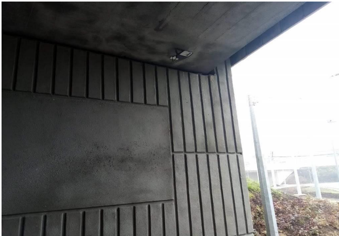
Slika 35. Kruti premaz/mort na prsnom zidu upornjaka
