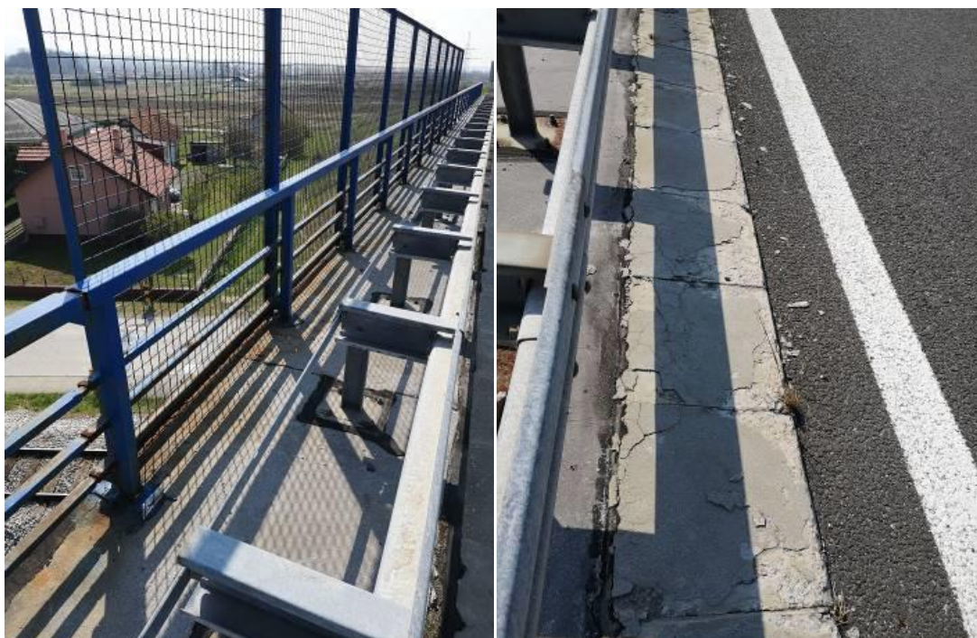
Slika 74. Oštećenja ograde, hodnika i rubnjaka nadvožnjaka
