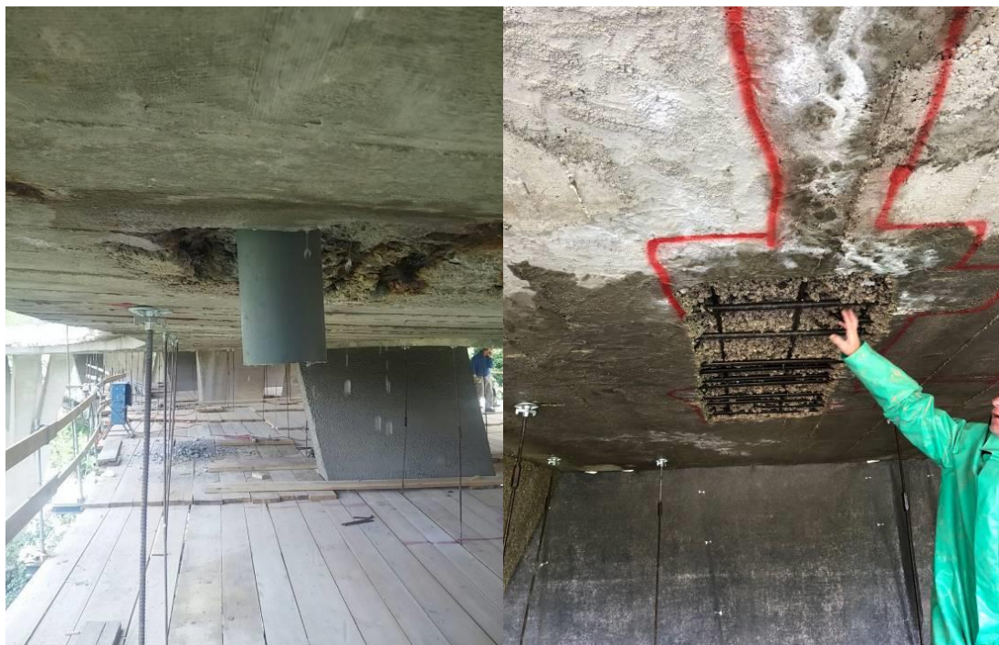
Slika 50. Oštećenja podgleda kolničke ploče te radovi hidrodinamičkog uklanjanja oštećenja
