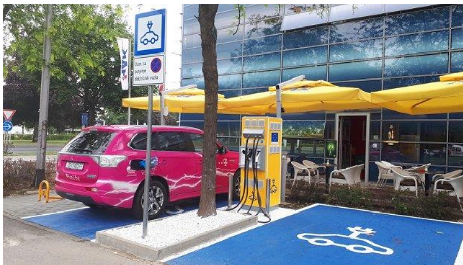
Slika 3 prikazuje punionicu za električna vozila
