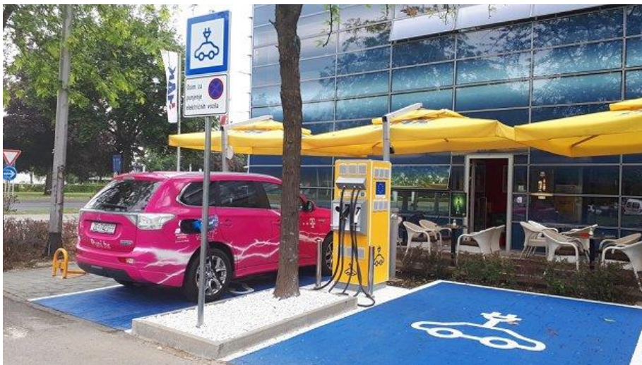
Slika 3 prikazuje punionicu za električna vozila
