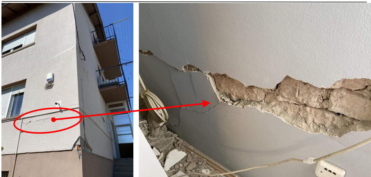
Slika 4.7. Horizontalna pukotina južnog nosivog zida;
