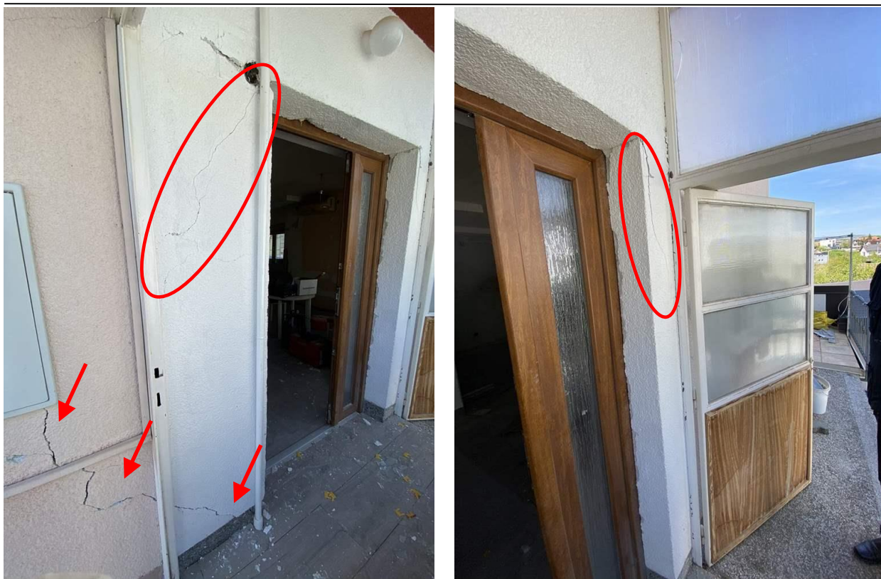
Slika 4.11. Dijagonalne pukotine uz otvor na ulazu u etažu 2;
