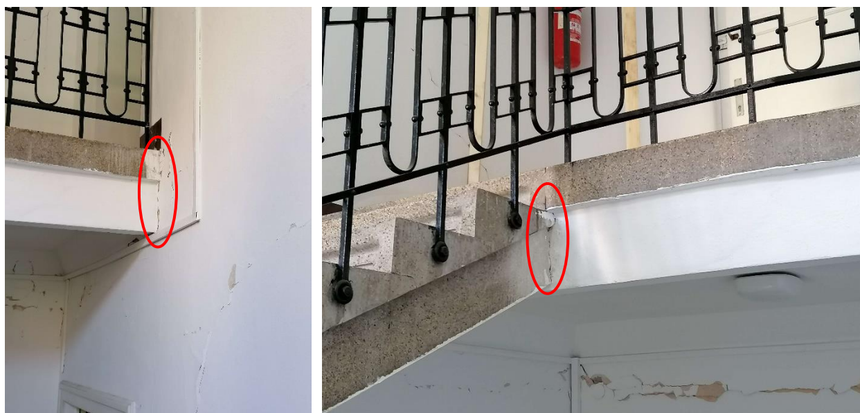
Slika 4.35. Vertikalne pukotine na spojevima stubišnog kraka
