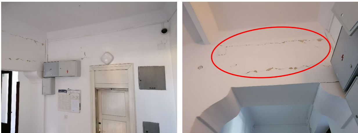
Slika 4.41. Pukotine u nadvoju, identične pukotinama u predmetnom stanu
