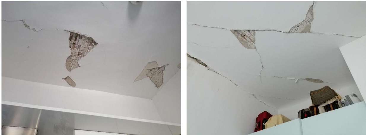
Slika 4.15. Dijagonalne pukotine po cijeloj površini stropa
