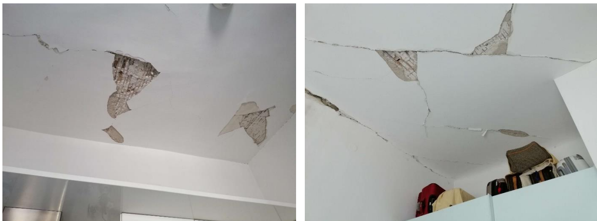
Slika 4.15. Dijagonalne pukotine po cijeloj površini stropa
