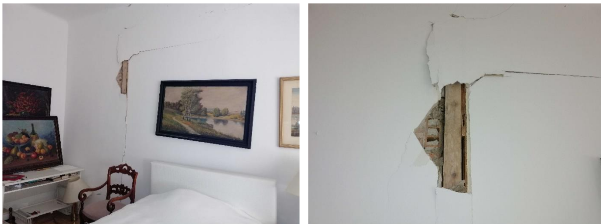
Slika 4.23. Poprijeko ispucani pregradni zid
