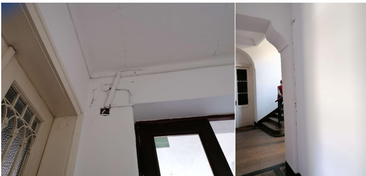
Slika 4.42. Oštećenja na nosivom dijelu nadoja u nosivom zidu prizemlja
