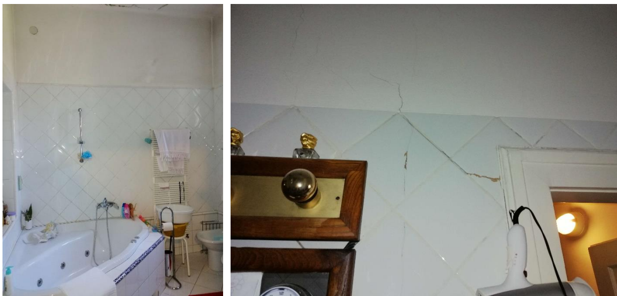
Slika 4.22. Pukotinska oštećenja u kupaonici
