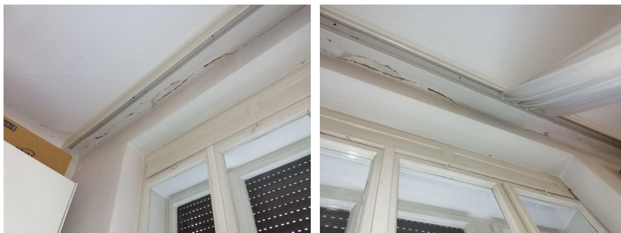
Slika 4.13. Spoj stropa i vanjskog nosivog zida, horizontalne pukotine
