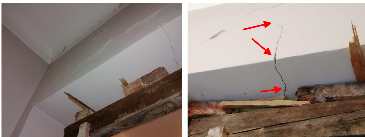
Slika 4.5. Jasno vidljiva struktura konstruktivne pukotine
