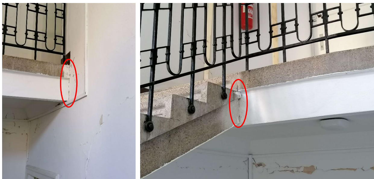
Slika 4.35. Vertikalne pukotine na spojevima stubišnog kraka
