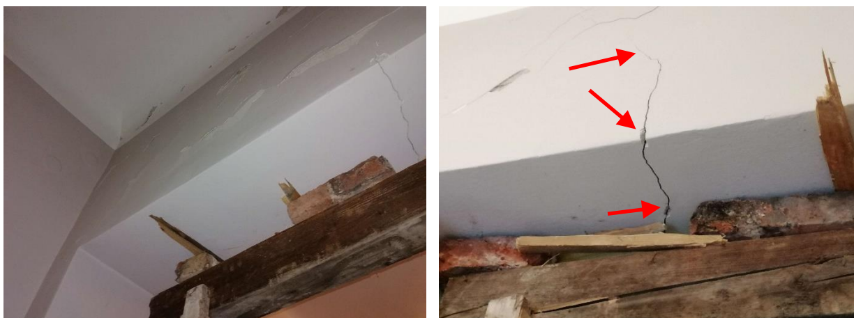
Slika 4.5. Jasno vidljiva struktura konstruktivne pukotine
