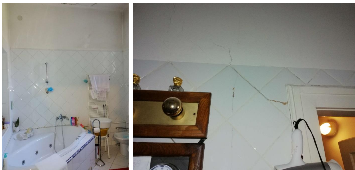
Slika 4.22. Pukotinska oštećenja u kupaonici
