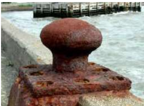
Slika 1 - Primjer opće korozije na metalnom predmetu zbog djelovanja morske vode
