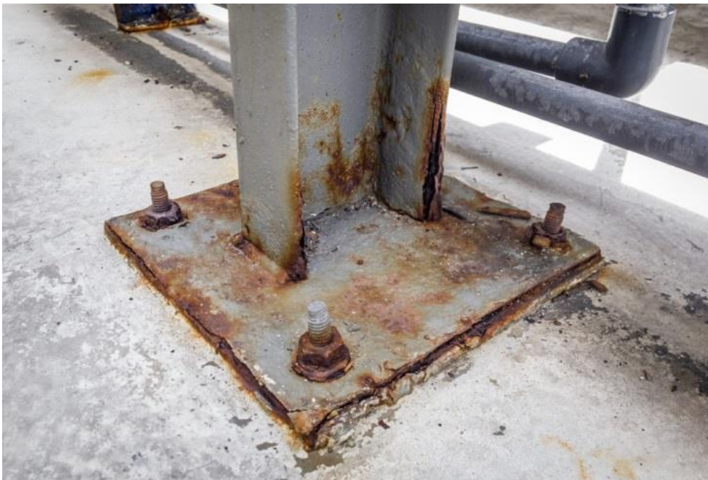
Slika 4: Korozijska u procijepu na loše izvedenim zavarima stupa i temeljne ploče [9]
