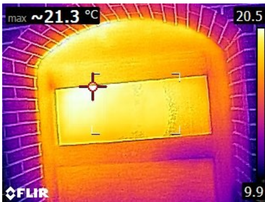
Slika 7-1 - Primjer loše izolacije na vratima
