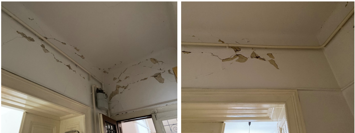
Slika 21. Pukotina nadvoja nosivog zida
