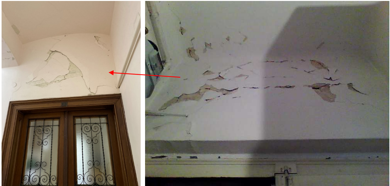
Slika 20. Pukotina s obje strane nosivog zida prema stubištu
