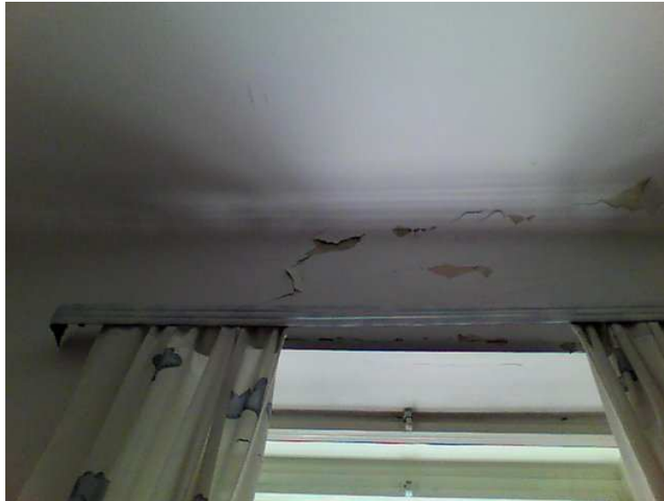
Slika 22. Pukotinska oštećenja nadvoja nad prozorom
