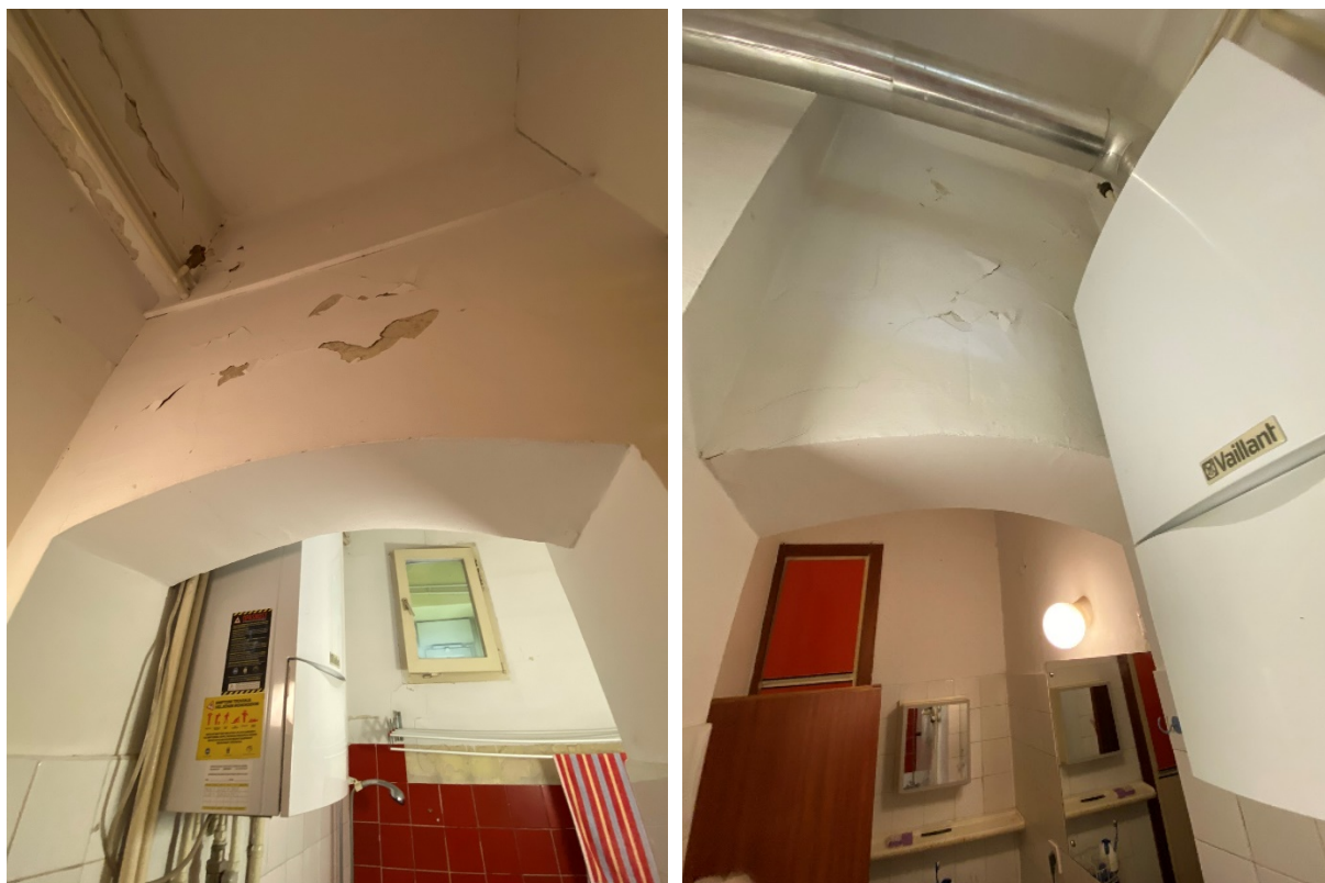
Slika 23. Pukotina nosivog luka
