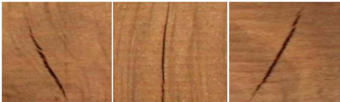
Slika 4. 9 Površinske pukotine – primjer [13]
