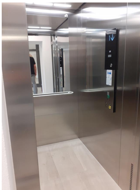
Slika 4.1.3.2. Prikaz unutrašnjosti dizala
