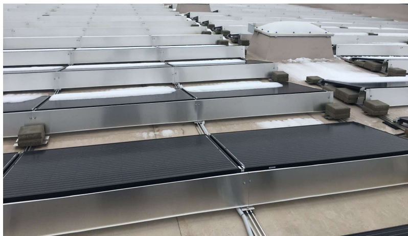
Slika 5.19 Fotonaponski moduli na krovu
