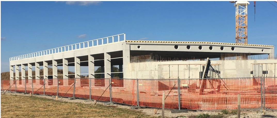
Slika 5.14 Ograda oko gradilišta
