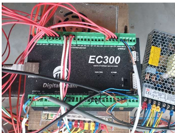
Slika 4.3 Probno spajanje CNC kontrolera
