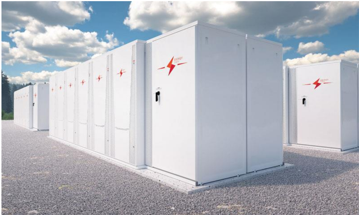
Slika 4.1 Postrojenje baterijskih spremnika [30]
