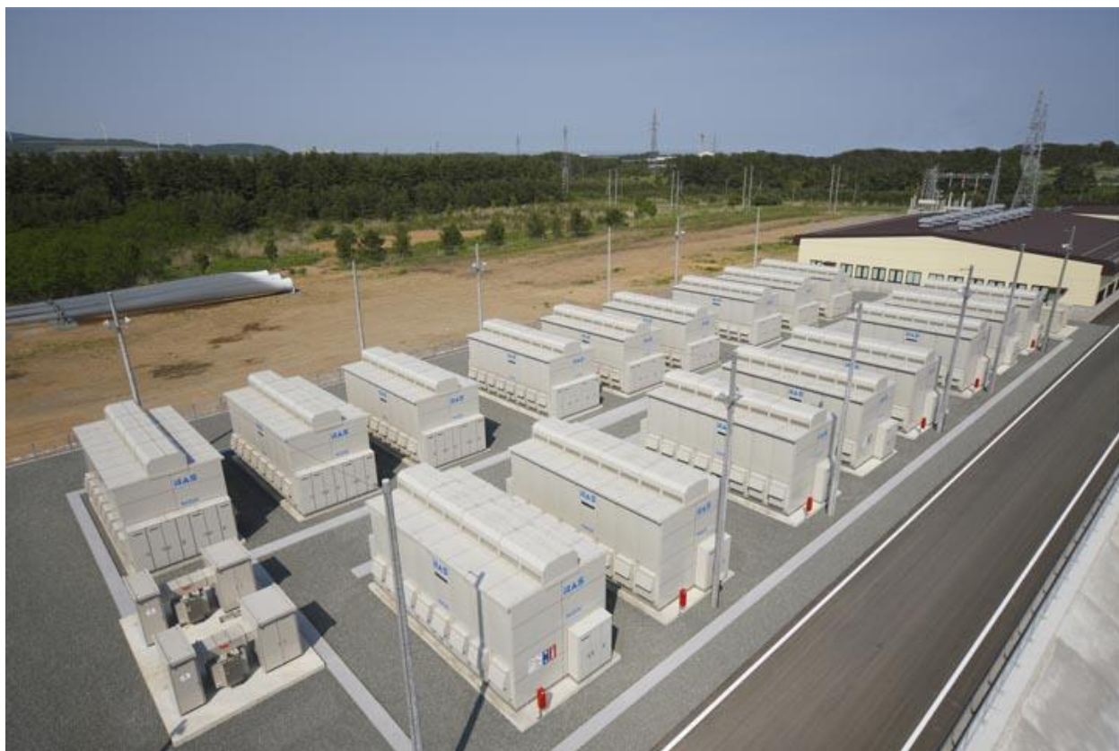
Slika 3.12 Rokkasho (Japan) - farma vjetroelektrana - na slici baterijski spremnici NaS [22]
