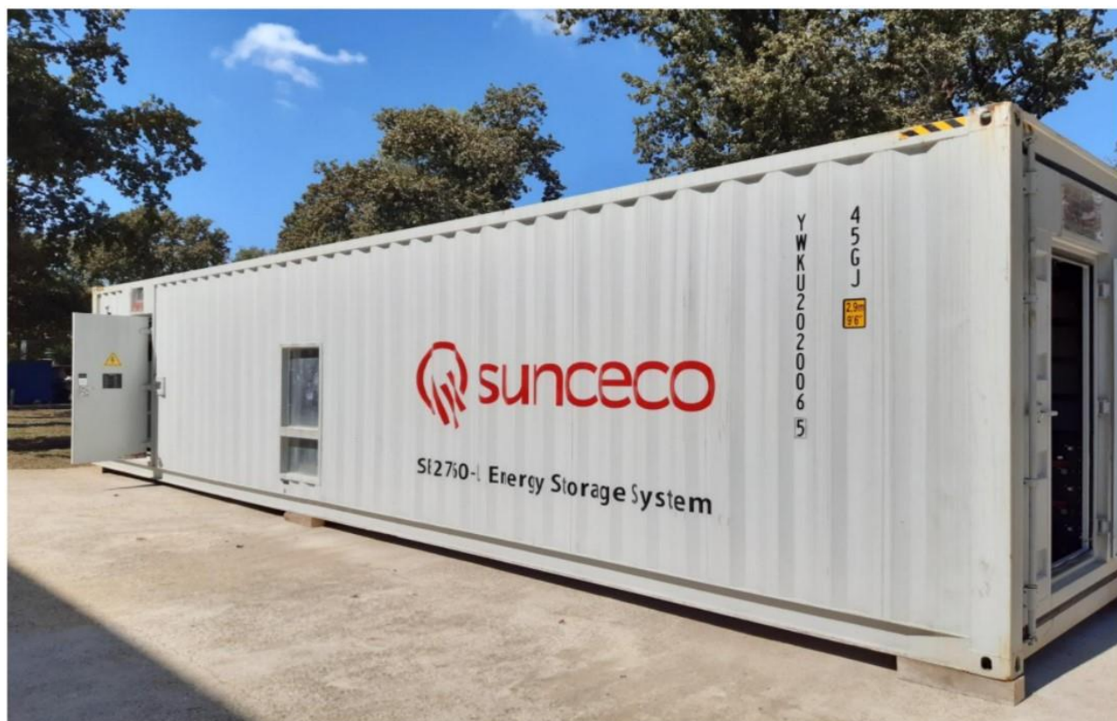
Slika 4.2 12.5 MWh Sisak, Hrvatska [32]
